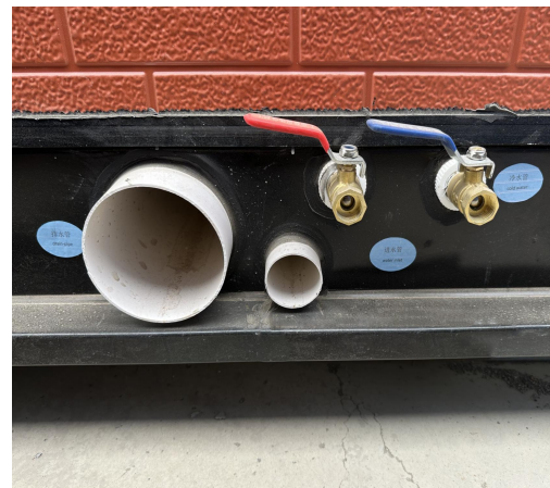
排水口、进水口 Drainage Outlet、Water Inlet
