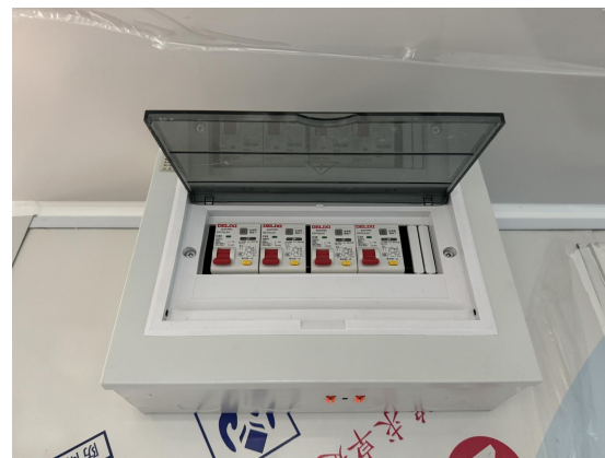
室内电源控制开关 Indoor Power Control Switch
